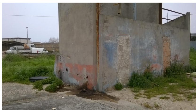
Foto 2016 evidenze di prodotto nelle tubazioni in prossimità della pensilina di carico del sito ex Laureti e evidenze di sversamenti sul piazzale (fratturato).
