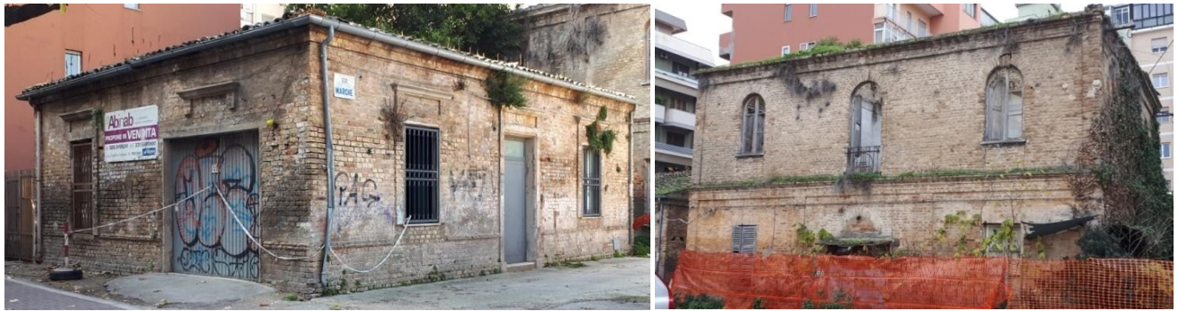
Fig 3 e 4: foto edifici in via Marche (ang. Via Lazio) da conservare e recuperare a destinazione pubblica
