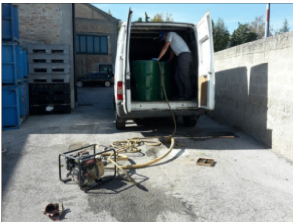
2) Esempio spurgo piezometro
